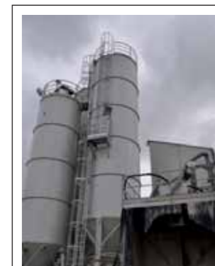
Centrali di calcestruzzo
