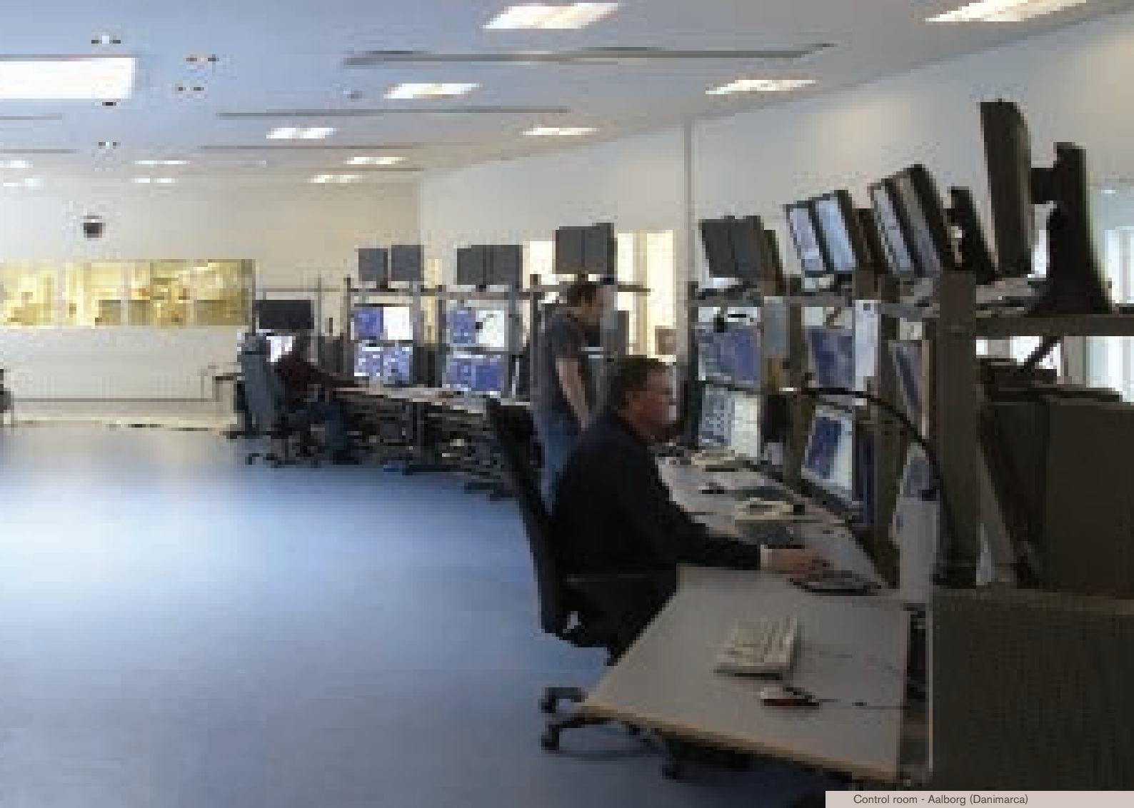
Control room - Aalborg (Danimarca)
